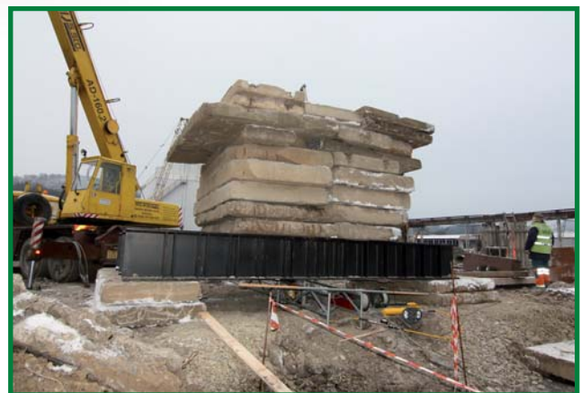
zatěžovací konstrukce tvořená protiváhou
